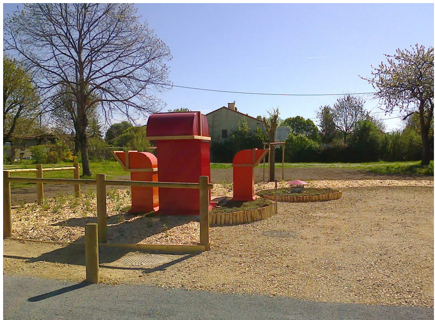
Figure 3 : poste Refoulement Amuré
