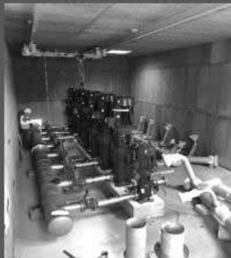
Nouvelle salle de reprise permettant d'exporter l'eau vers l'ensemble des communes du secteur.
